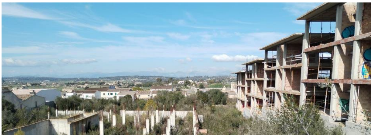
Imatge 14: Edifici en estat de abandono
